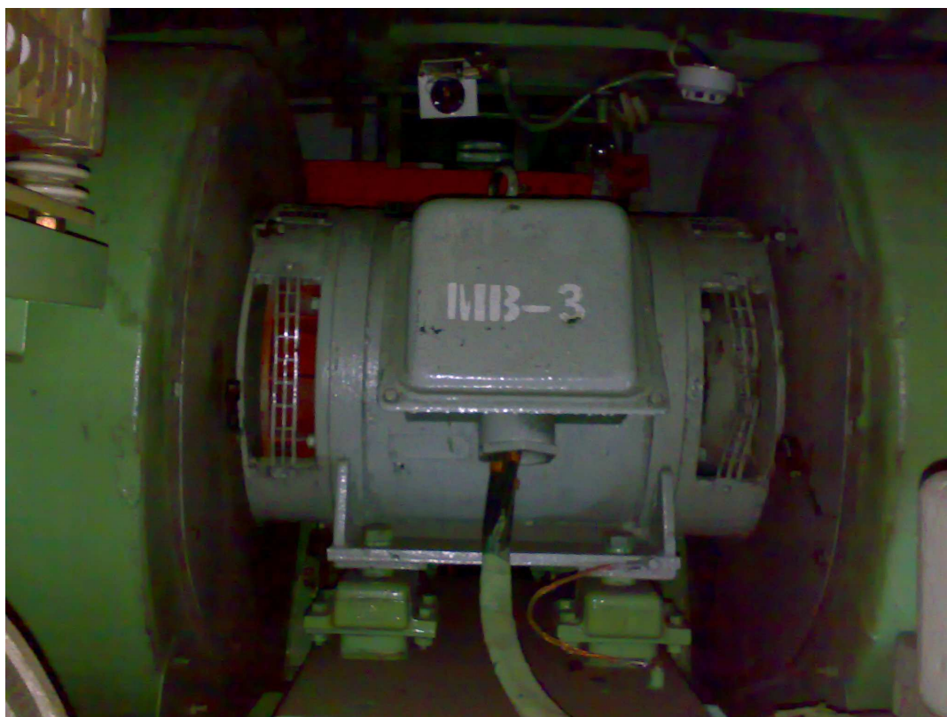
Рисунок 5 – Вид блока вентиляторов с электродвигателем
